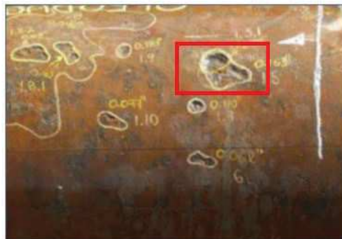
Figura 6.1: Defeito de corrosão em duto, adaptado de [21]
