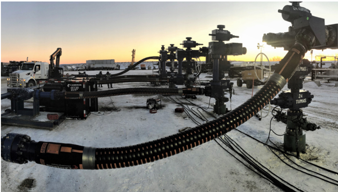
Figura 2.8: Mangueiras de transição poço-oleoduto
