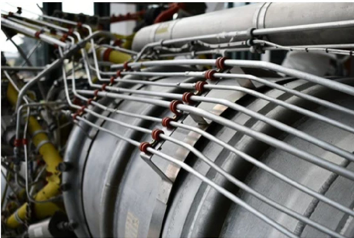
Figura 2.4: Tubulações das turbinas
