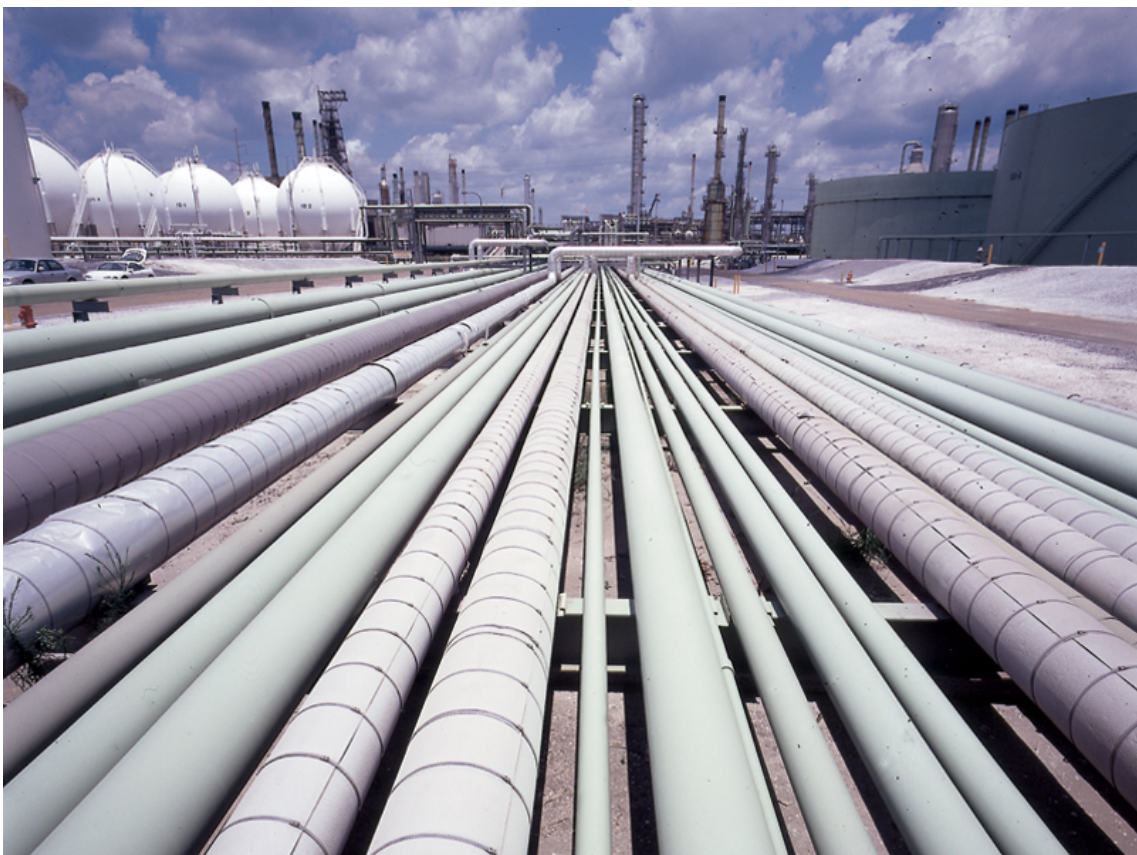
Figura 2.10: Tubulações numa refinaria
